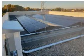
Centre des pompiers (SDIS) - 30 kWc (Toulouse)
