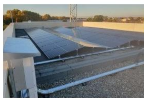
Centre des pompiers (SDIS) - 30 kWc (Toulouse)
