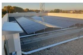
Centre des pompiers (SDIS) - 30 kWc (Toulouse)
